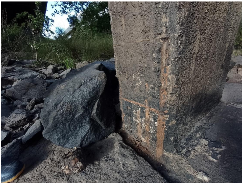
Figure 11 – Pilar do apoio P2 - Armadura exposta e presença de corrosão
