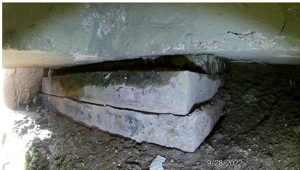
Figure 5 - Encontro E2 - Aparelhos de apoio VL1
