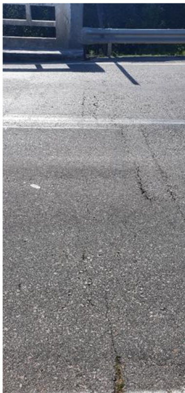
Figure 51 – Pavimento – Inexistência de junta E2
