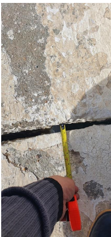
Figure 53 – Passeio - Junta de dilatação
