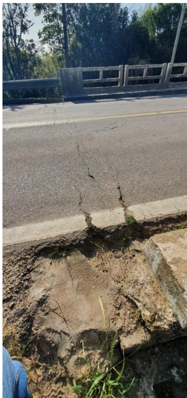
Figure 50 – Pavimento – Inexistência de junta E2
