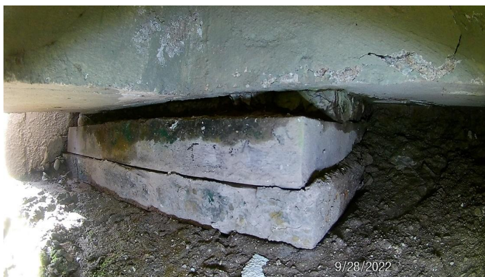
Figure 4 - Encontro E1 - Aparelhos de apoio VL2
