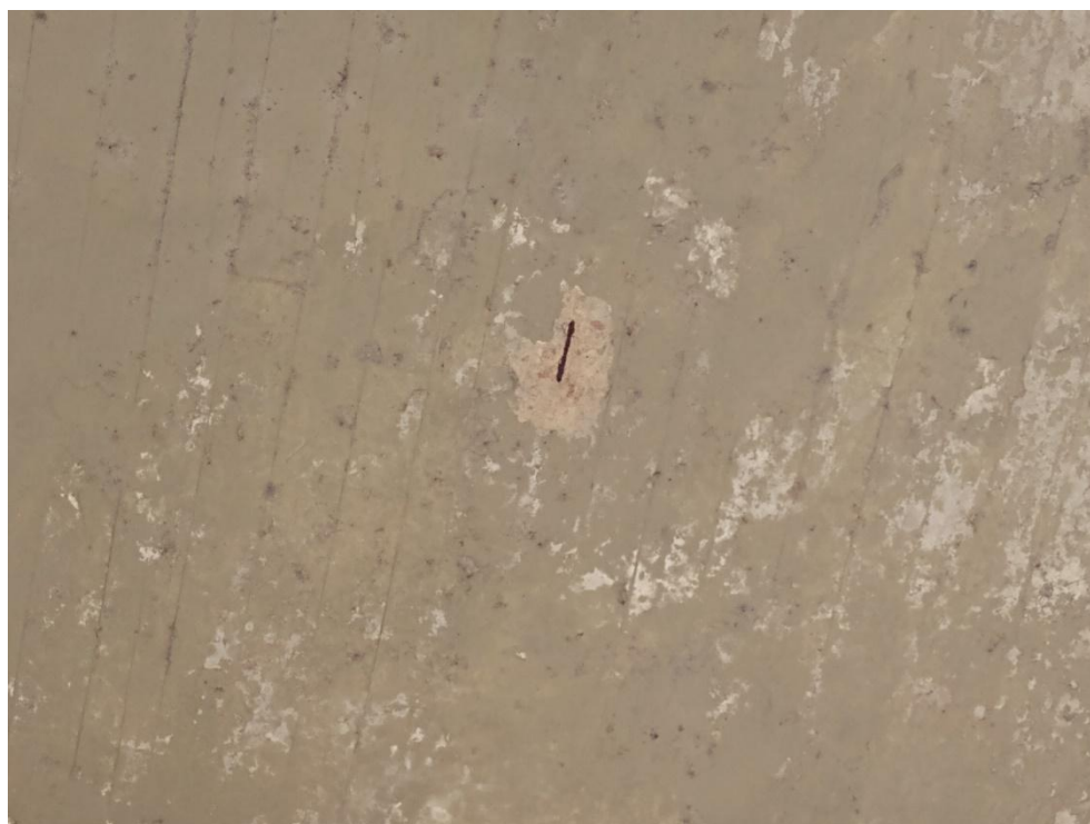
Figure 39 – Tabuleiro - Armadura exposta
