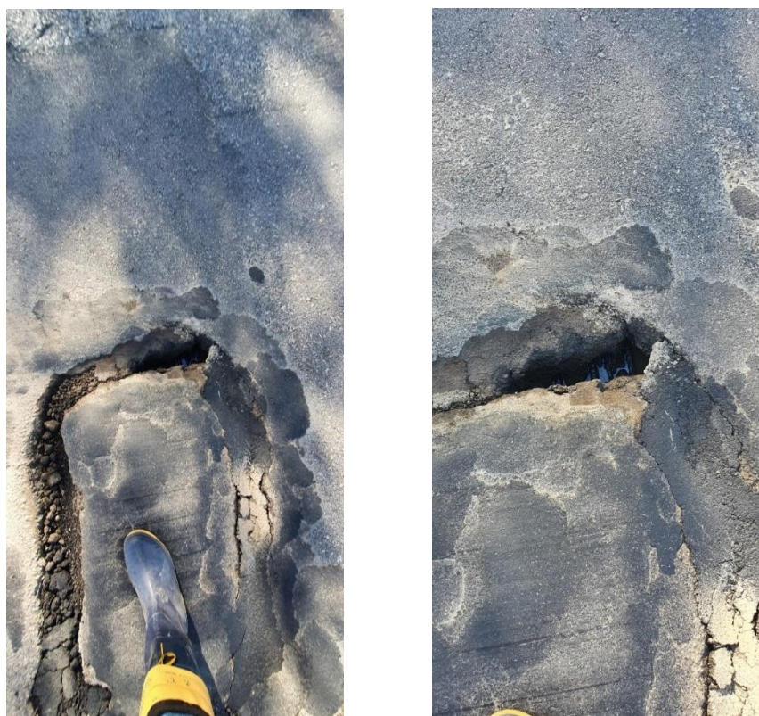
Figure 45 – Tabuleiro - Buraco entre os apoios P4/P5
