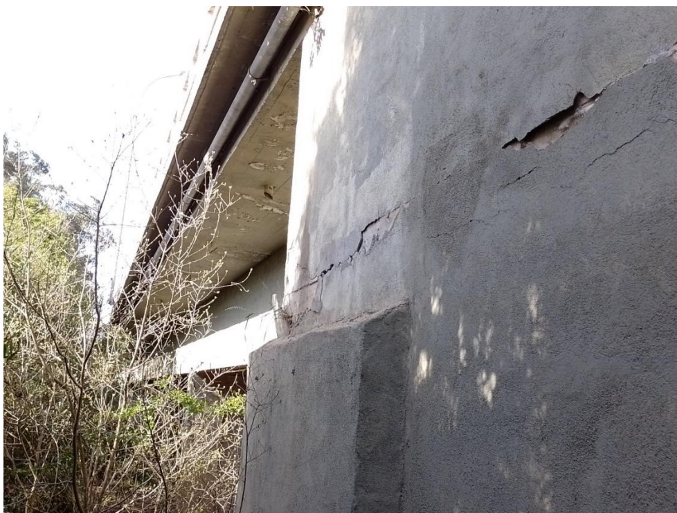
Figure 22 - Encontro E2 - parede rompida
