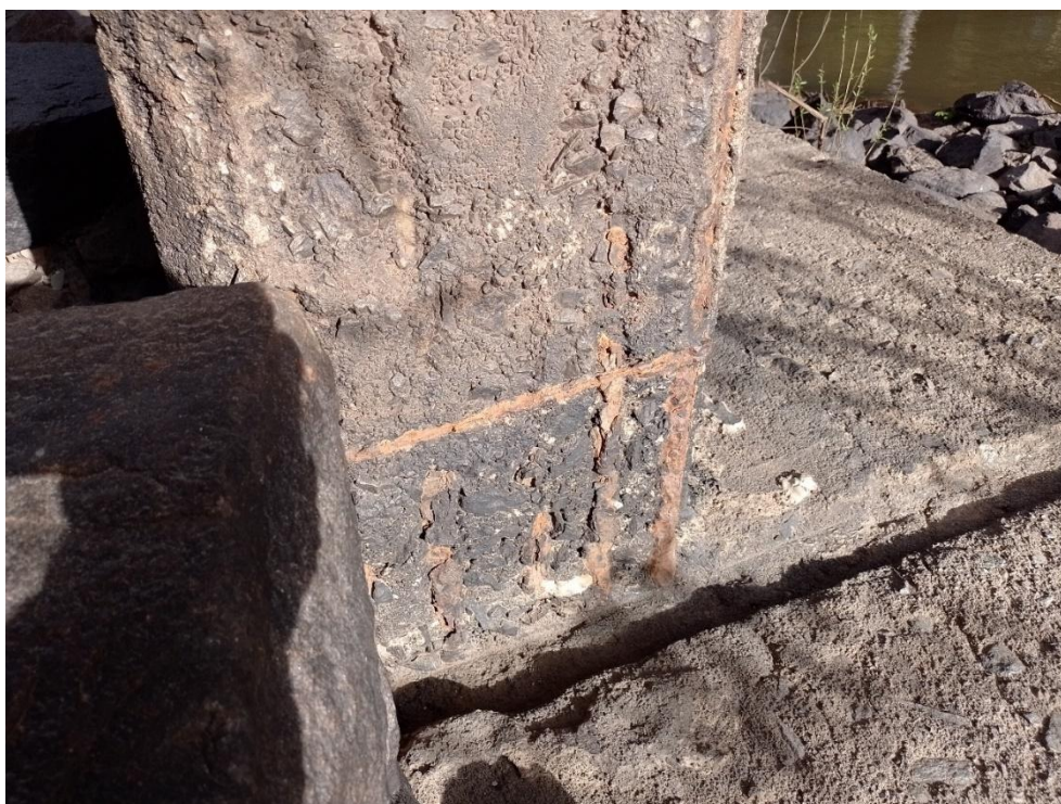
Figure 12 - Pilar do apoio P2 - Armadura exposta e presença de corrosão
