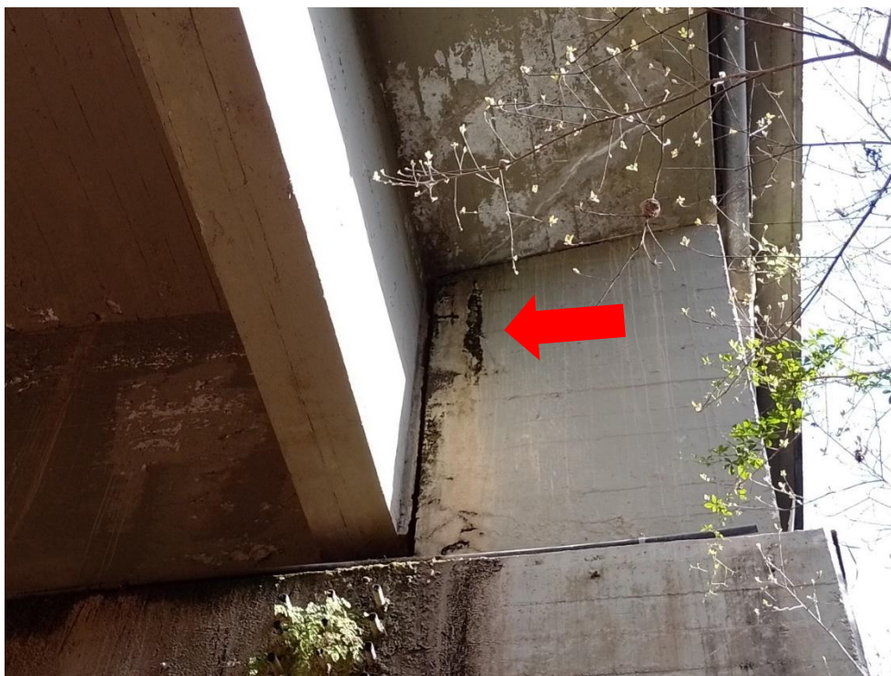
Figure 21 – Encontro E2 - Armadura exposta
