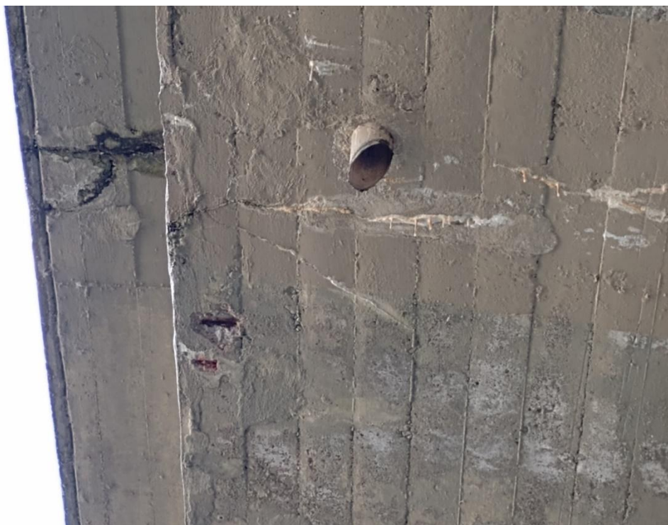
Figure 27 – Balanço - Armadura exposta no balanço
