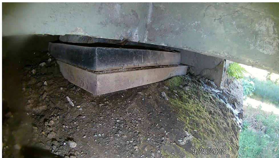
Figure 3 – Encontro E1 – Aparelhos de apoio VL1
