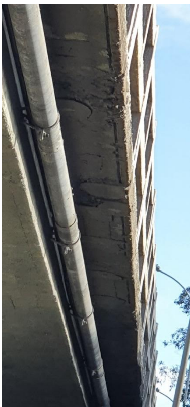
Figure 30 – Passeio - Armaduras expostas
