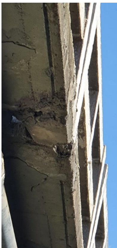
Figure 28 – Passeio – Passeio danificado
