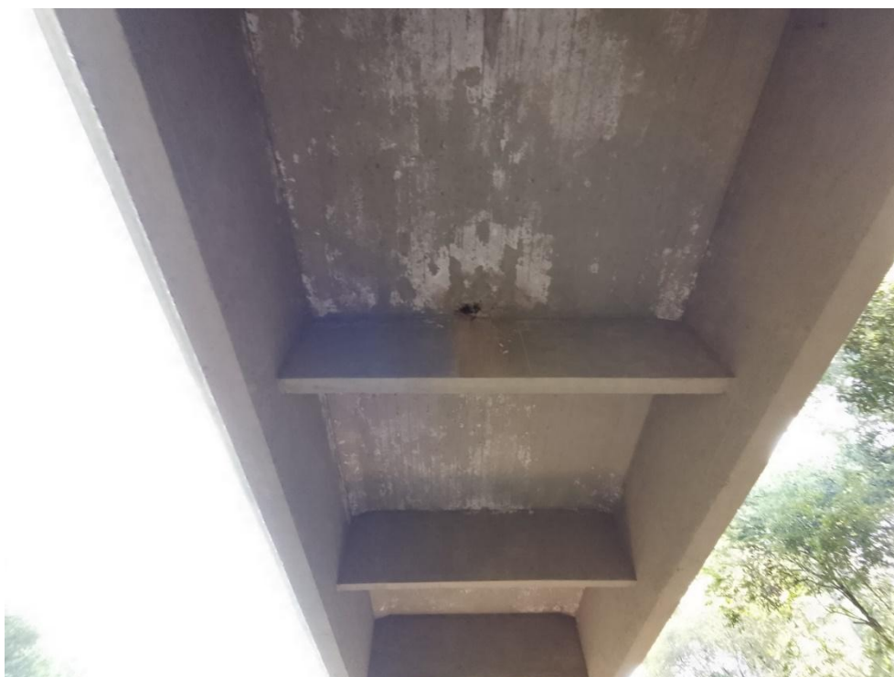
Figure 26 – Tabuleiro- Buraco entre os apoios P4/P5
