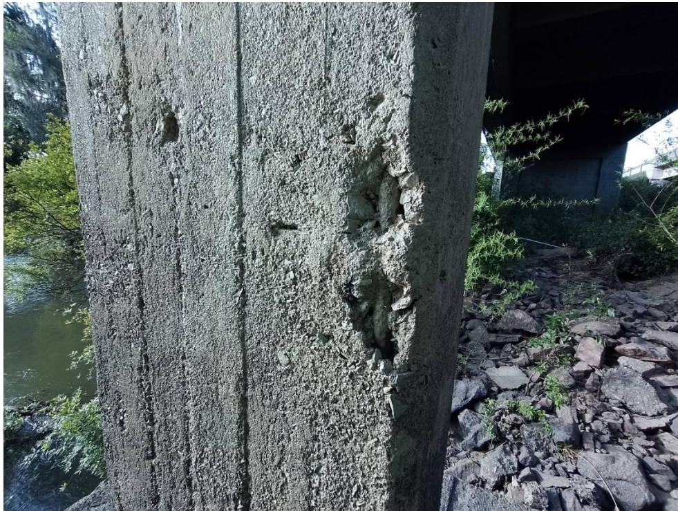
Figure 13 – Pilar do apoio P2 - Armadura exposta
