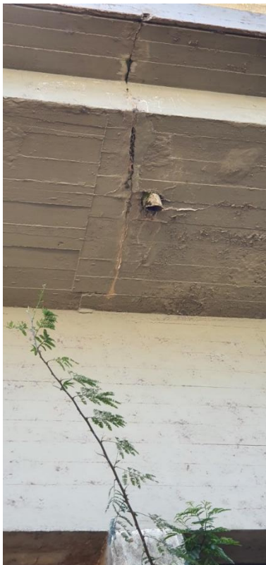
Figure 29 – Balanço - Trinca no balanço
