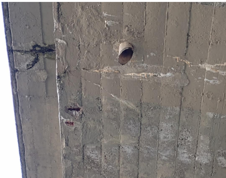
Figure 44 – Balanço - Infiltração no passeio e armadura exposta no balanço
