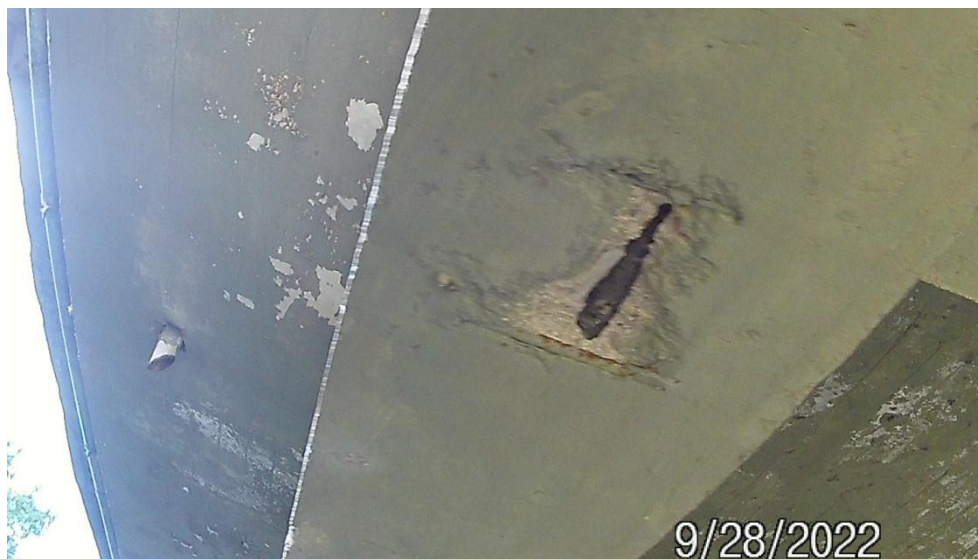
Figure 36 – VL - Armadura exposta na face inferior da longarina
