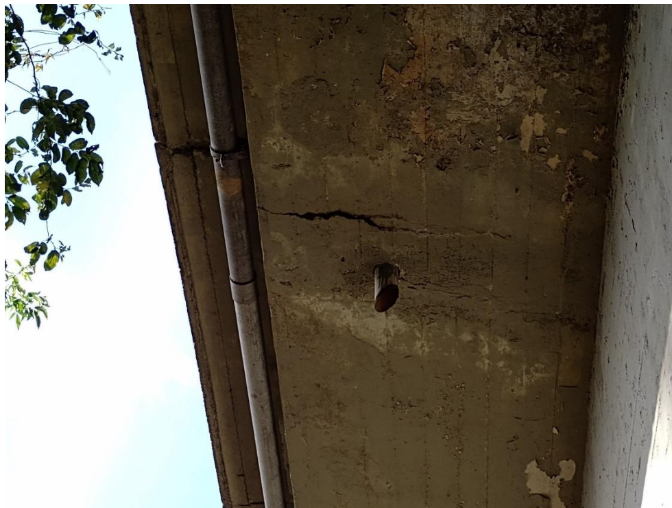
Figure 38 – Balanço - Fissura na laje do balanço
