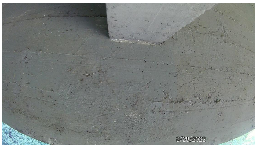
Figure 37 – VL - Fissura na face interna da longarina
