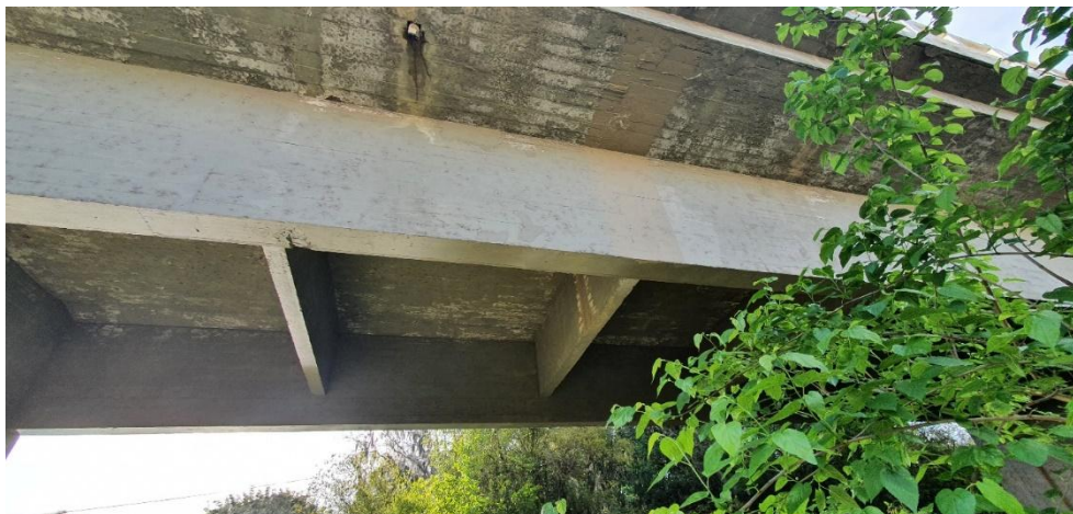
Figure 33 – VL - Concreto degradado na longarina
