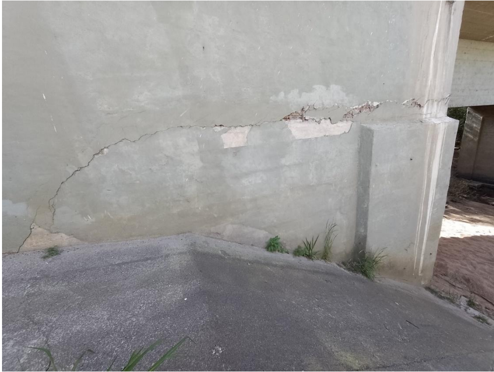
Figure 23 - Encontro E2 LE - Armaduras expostas
