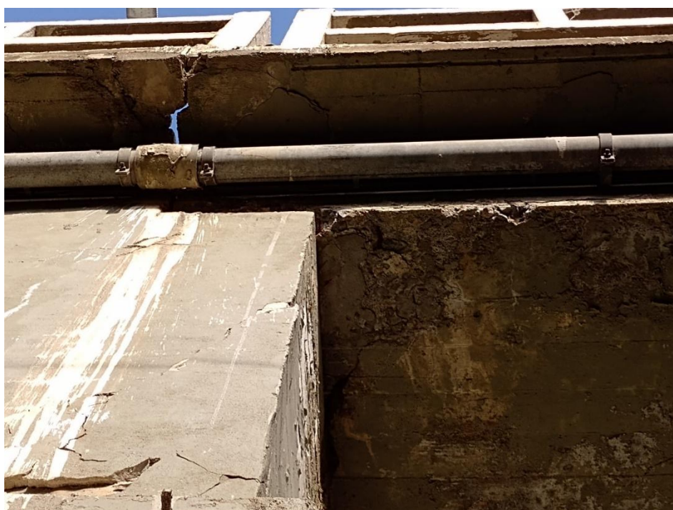
Figure 8 – Encontro E1 - parede rompida
