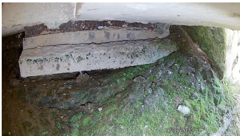
Figure 6 - Encontro E2 - Aparelhos de apoio VL2
