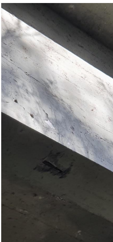
Figure 32 – VL - Armadura exposta na face inferior
