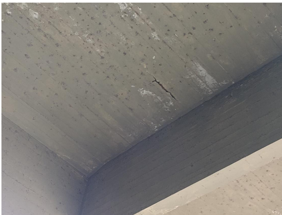
Figure 43 – Tabuleiro - Trinca na laje
