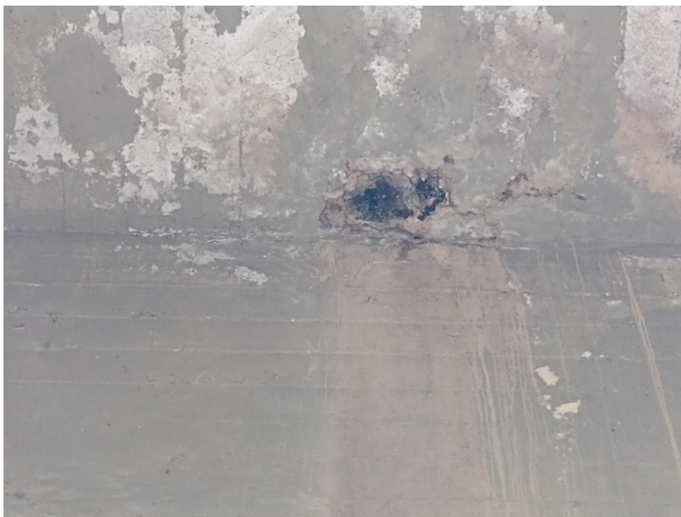
Figure 46 – Tabuleiro - Buraco entre os apoios P4/P5
