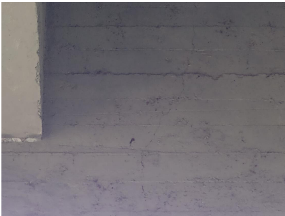
Figure 25 – VL1 - Trincas entre os apoios P6/P7
