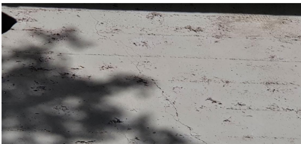
Figure 35 – VL - Fissura na face externa da longarina
