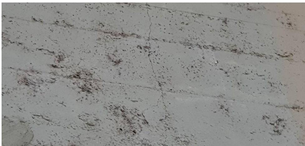
Figure 34 – VL - Fissura na face externa da longarina
