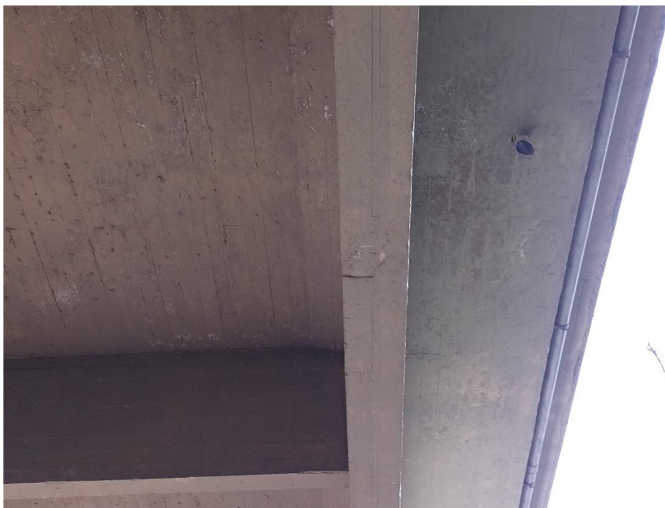
Figure 40 – VL - Deslocamento de concreto
